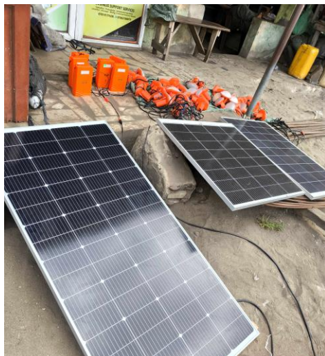
太陽光パネルとバッテリー
