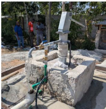
電動での揚水確認
